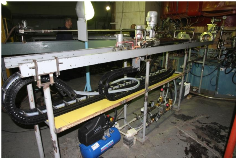
Рис. 3. Загальний вигляд опромінювальної установки.
